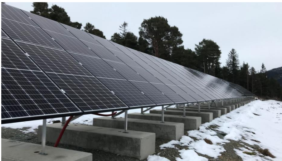
Figur 1 - Bakkemontert solcelleanlegg på Byneset, Trondheim. Foto: Erik Due, NVE.
