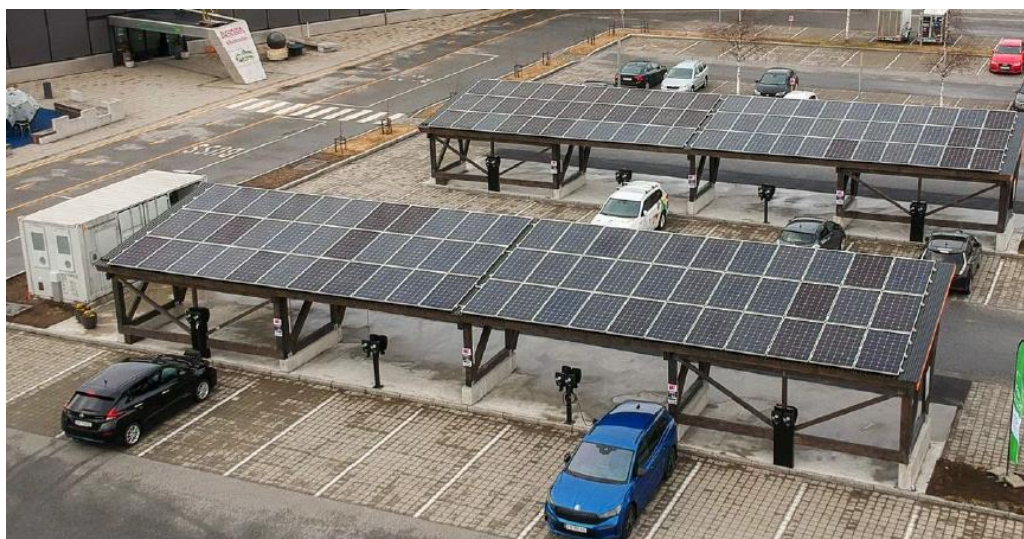
Figur 7 - Tak over parkeringsplasser med ladestasjon. Bilde: Solcellespesialisten AS
